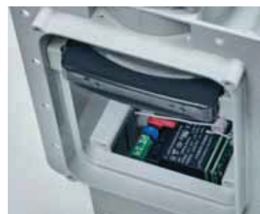
Empfänger im Gegendosen-Fach des Sense-Systems installiert
